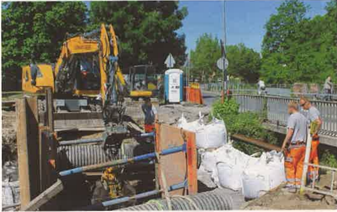
Derzeit werden an der Brücke an der Schwetzinger Straße die Versorgungsleitungen bearbeitet.
